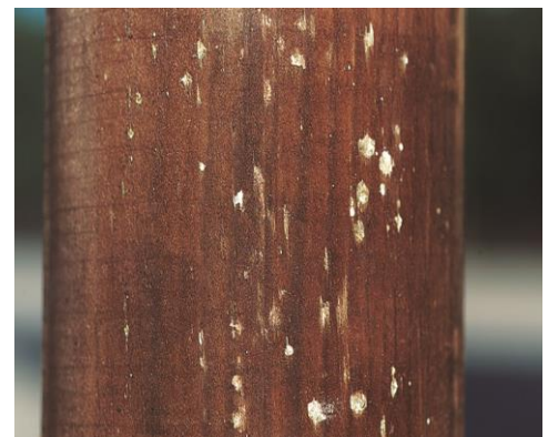
Bild 15: Salzausblühungen auf KDI-Ware
