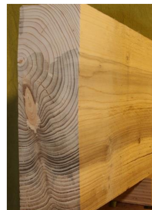
Bild 9: Balken mit gesundem Holz – oben und fließendem Übergang von Rotstreife verfärbtem und Rothäute befallenen Holz
